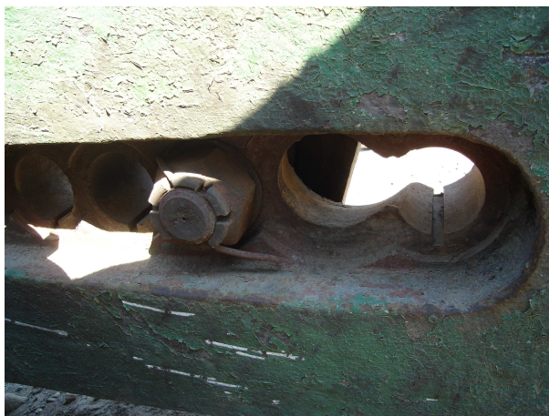
Рисунок 2 – Руйнування стінки між сусідніми отворами кривошипа
