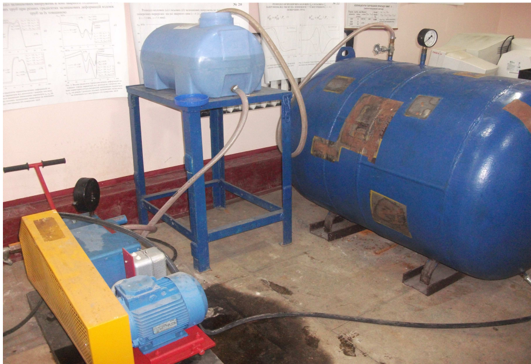
Рисунок 4 – Насосна станція дослідницького стенду
