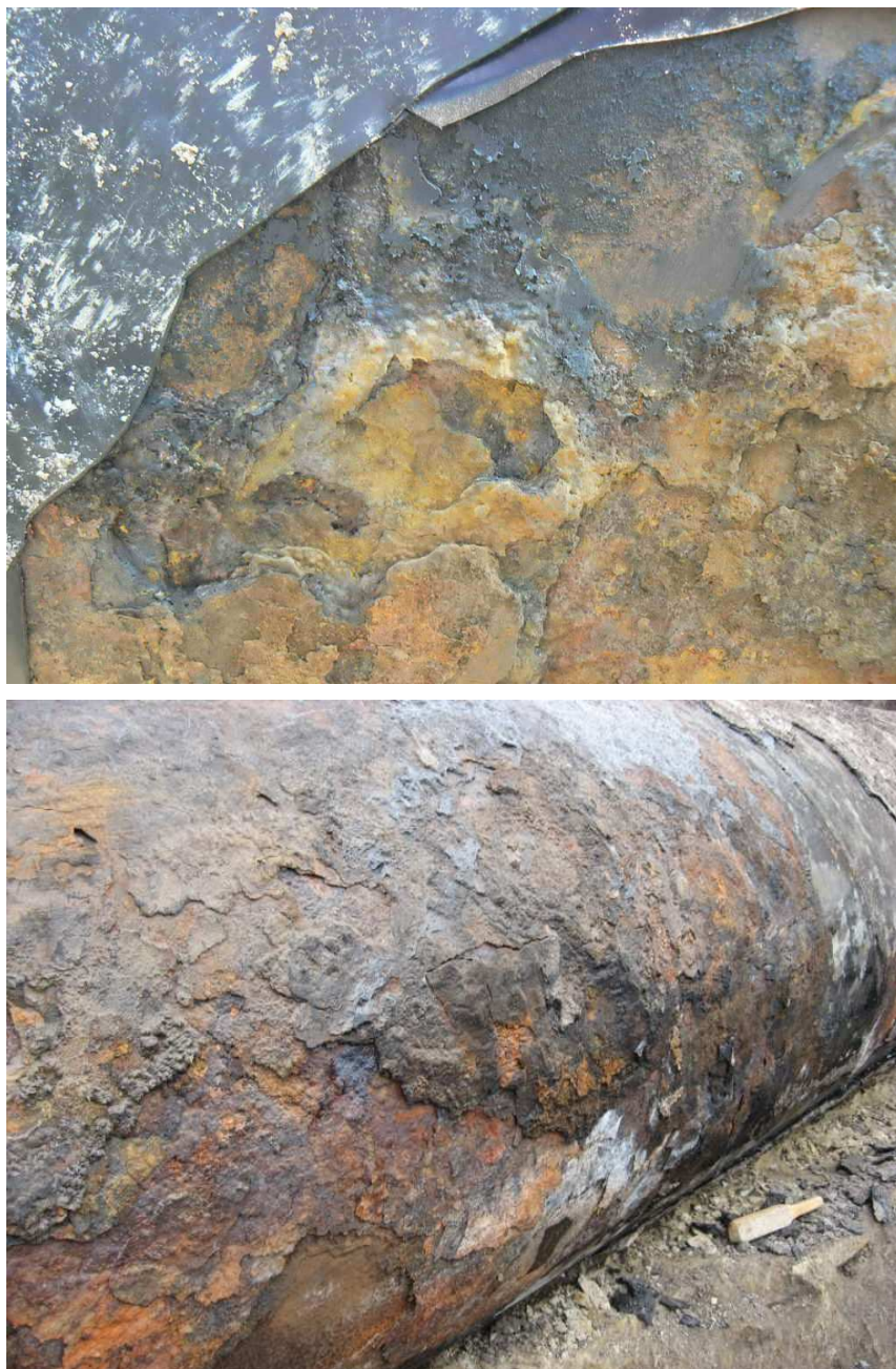
Рисунок 1 – Дефекти бітумної ізоляції
