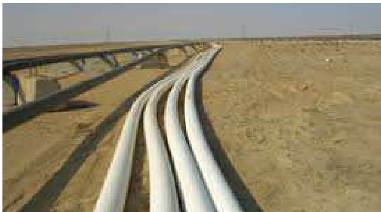
Рисунок 11 – Наземно прокладені гнучкі композитні трубопроводи
