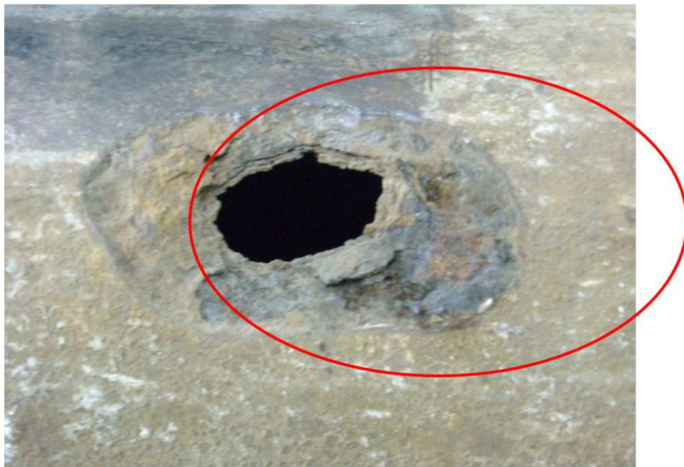
ж) наскрізний дефект корозійного походження; зона ураження – 35 мм, умовний розмір отвору – 12 мм
