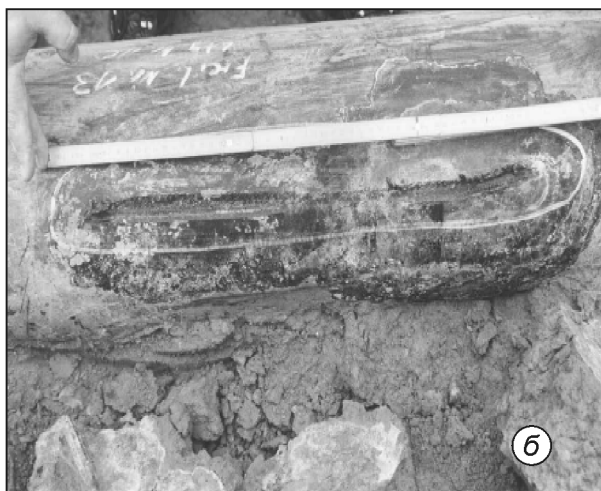
Рисунок 3 – Типові корозійні експлуатаційні дефекти газопроводів, спричинені пошкодженням ізоляційного покриття внаслідок відшарування (а) та ремонтними роботами (б) [6]
