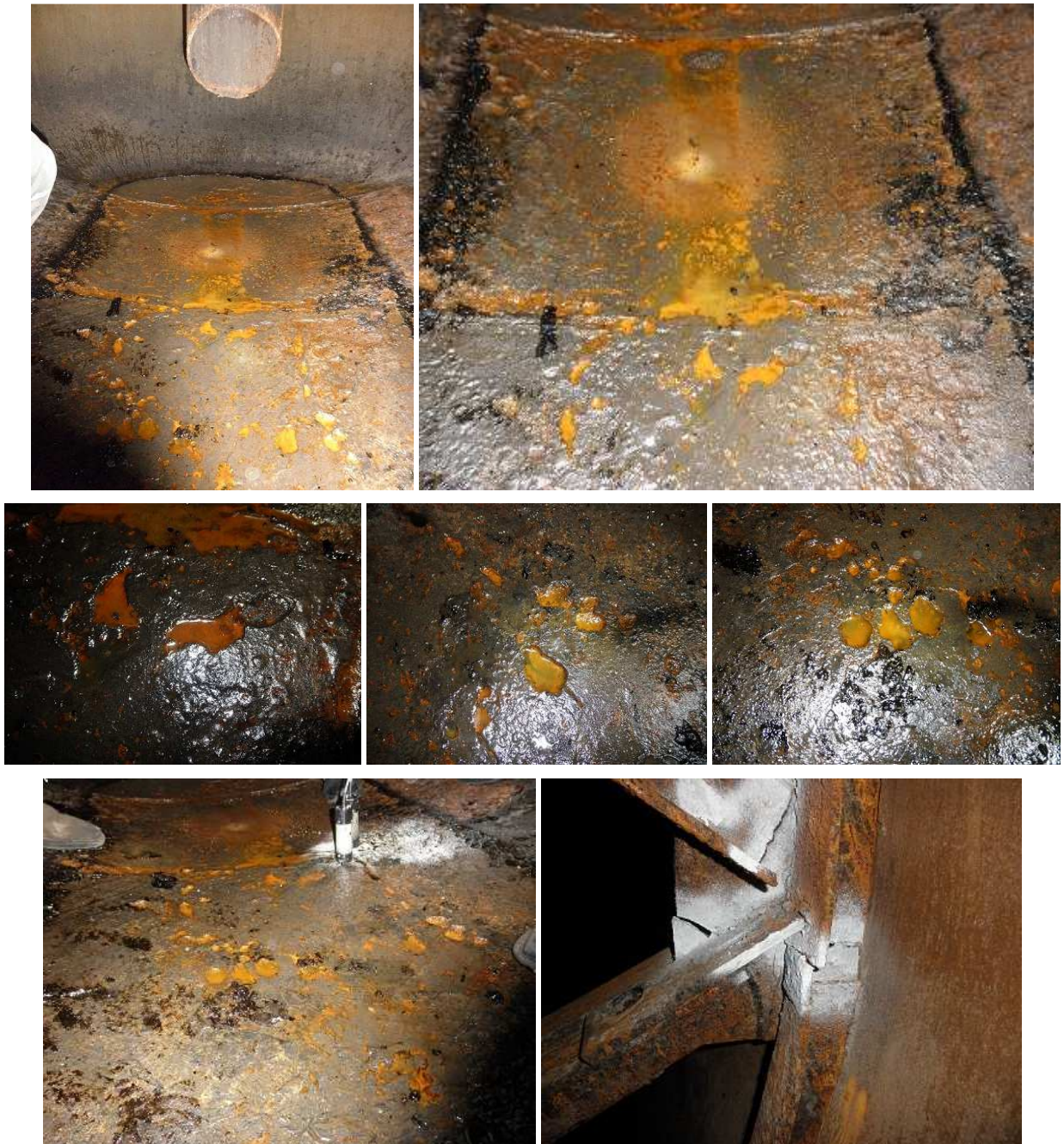
Рисунок 3 –Дефекти, виявлені при технічному огляді буферної ємності ПЕ 200-16 ГС
