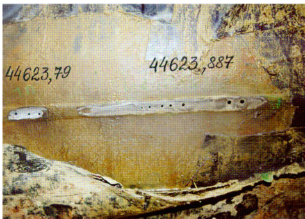
Рисунок 7 – Приклад дефекту зварного з'єднання основного металу трубопроводу
