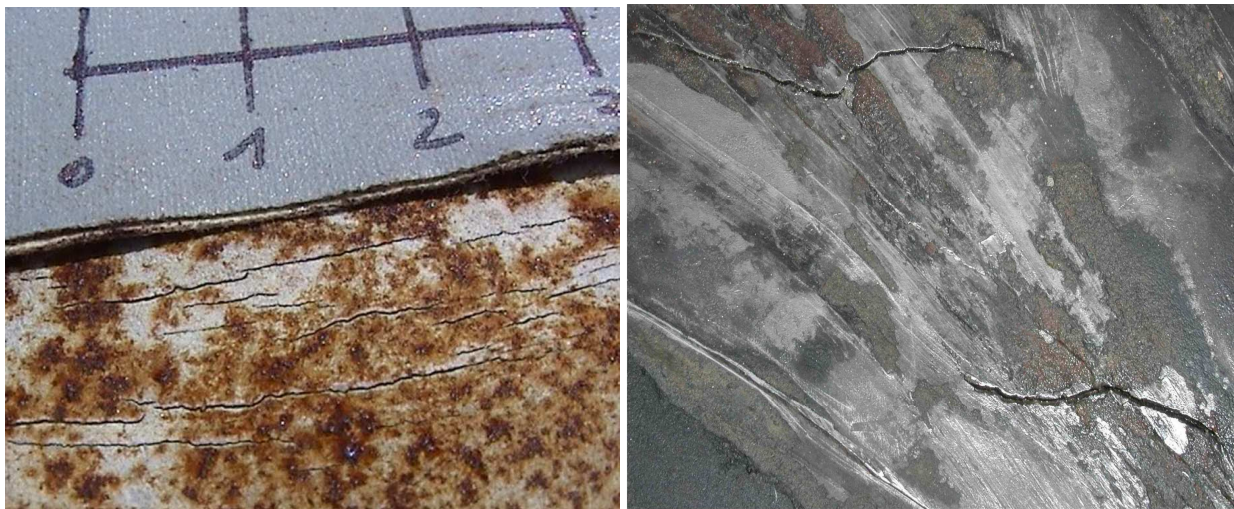
Рисунок 1 – Приклади наявності поверхневих тріщин основного металу технологічної обв'язки НПС магістральних нафтопроводів
