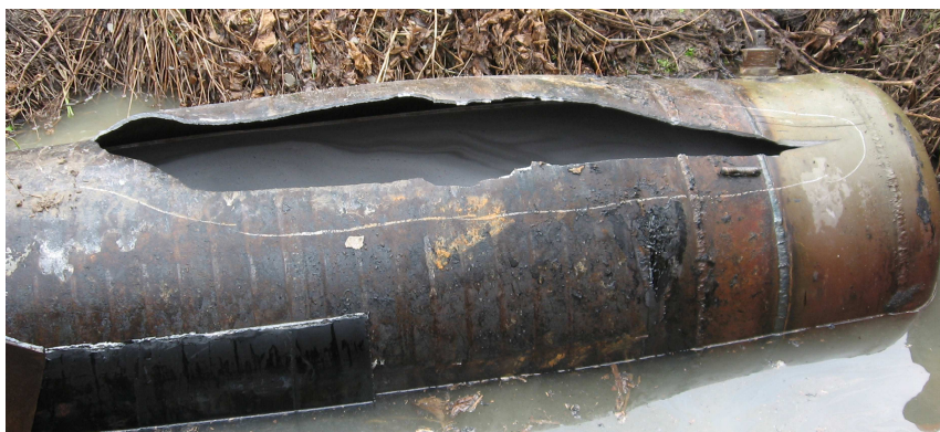
Рисунок 7 – Ділянка руйнування труби
